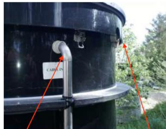
Kabelgennemføring til teknik-kasse
